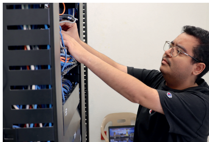
Mantenimiento preventivo a site
